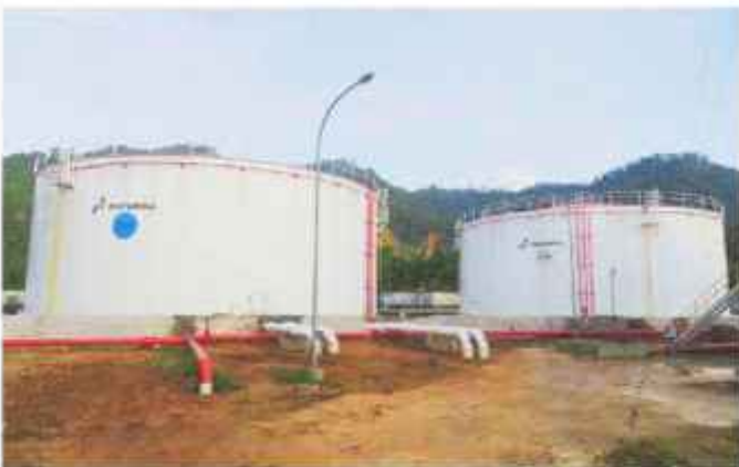
Tank 2 x 10.000 KL Pertamina - West Sumatra
